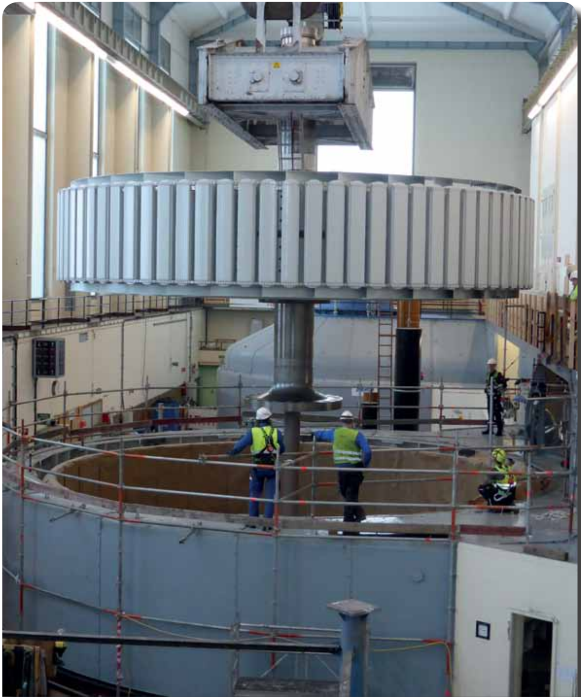
Rotor der Maschine M2 am Kran
