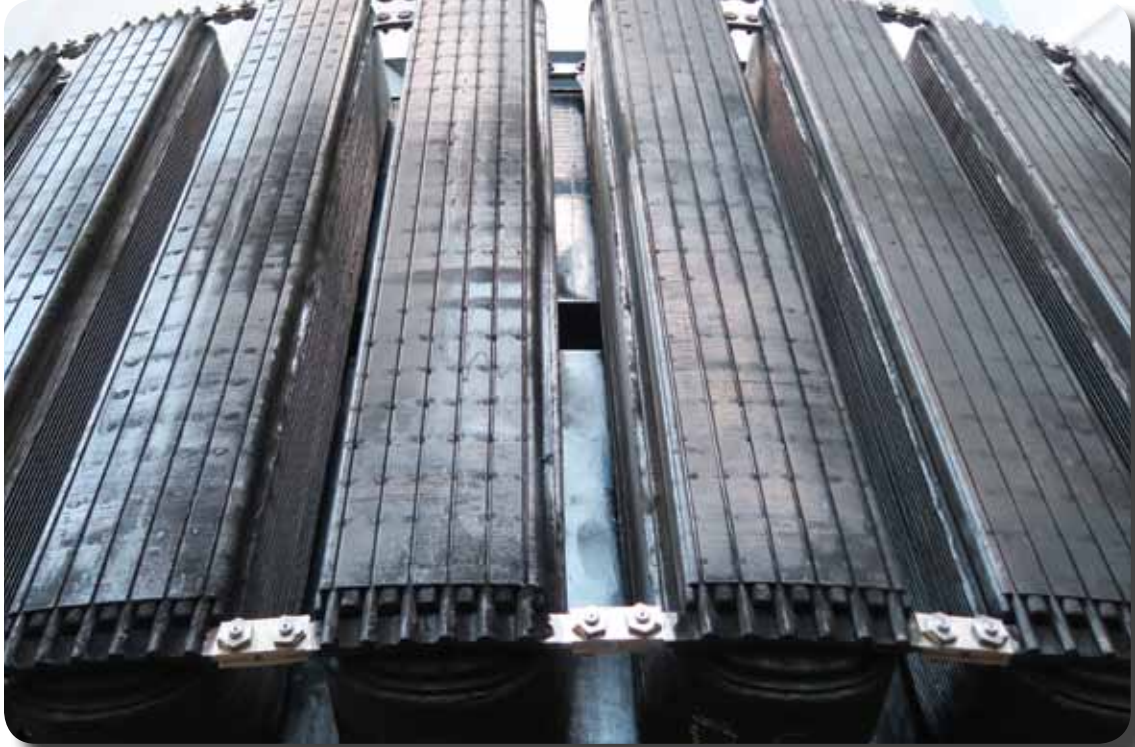
Generator Rotor „Retrofit“ Maschine 2
